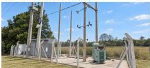
VISTA GENERAL - TRANSFORMADOR 0,8 MVA
