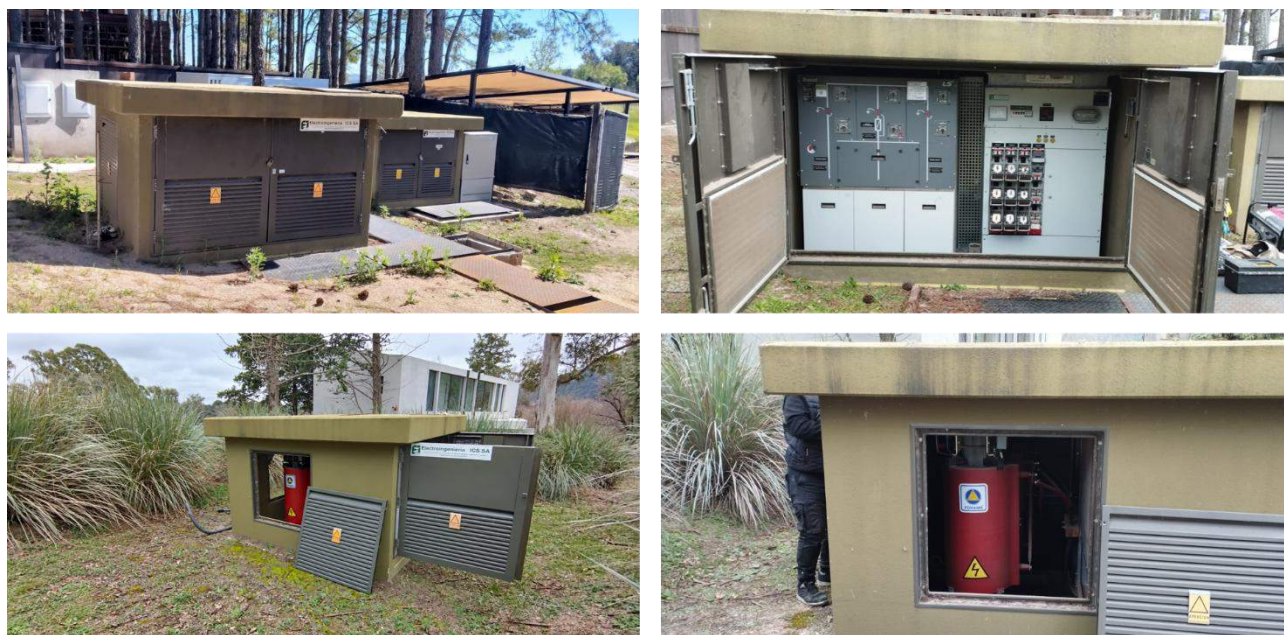
Centros compactos MT/BT Loteo Molvento
