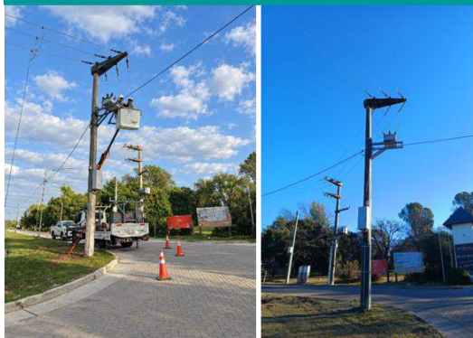
R-229 (13,2 kV) Calidad de Servicio Los Manantiales e ingreso Loteo Manantiales, VGB
