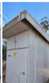
CELDA DE 33 kV
