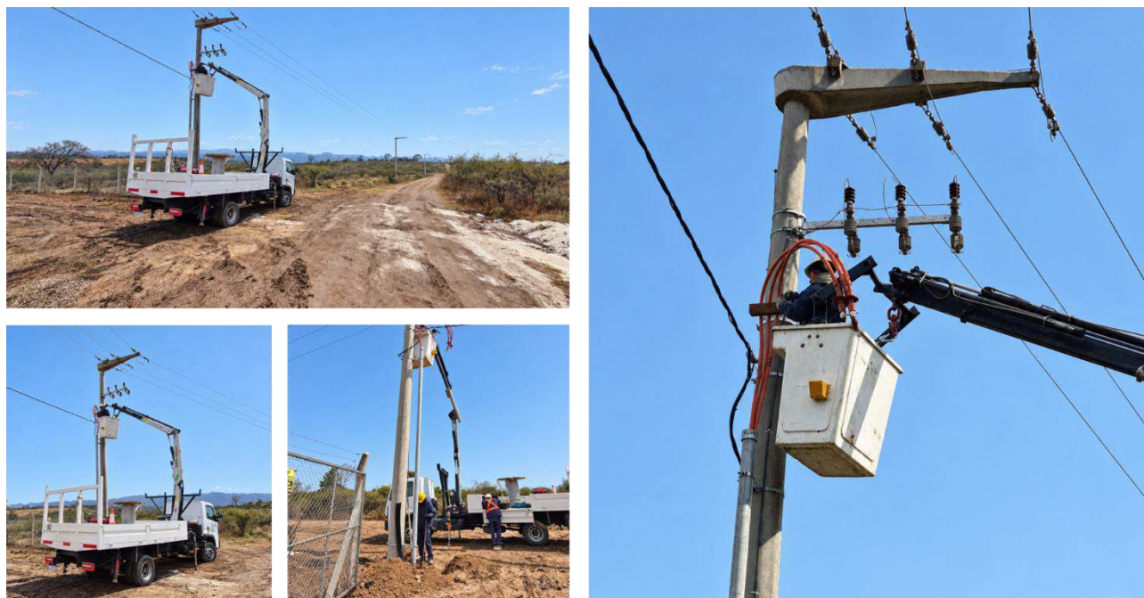
Punto de inyección del PSFV con la Red de Distribución de MT de la Cooperativa
