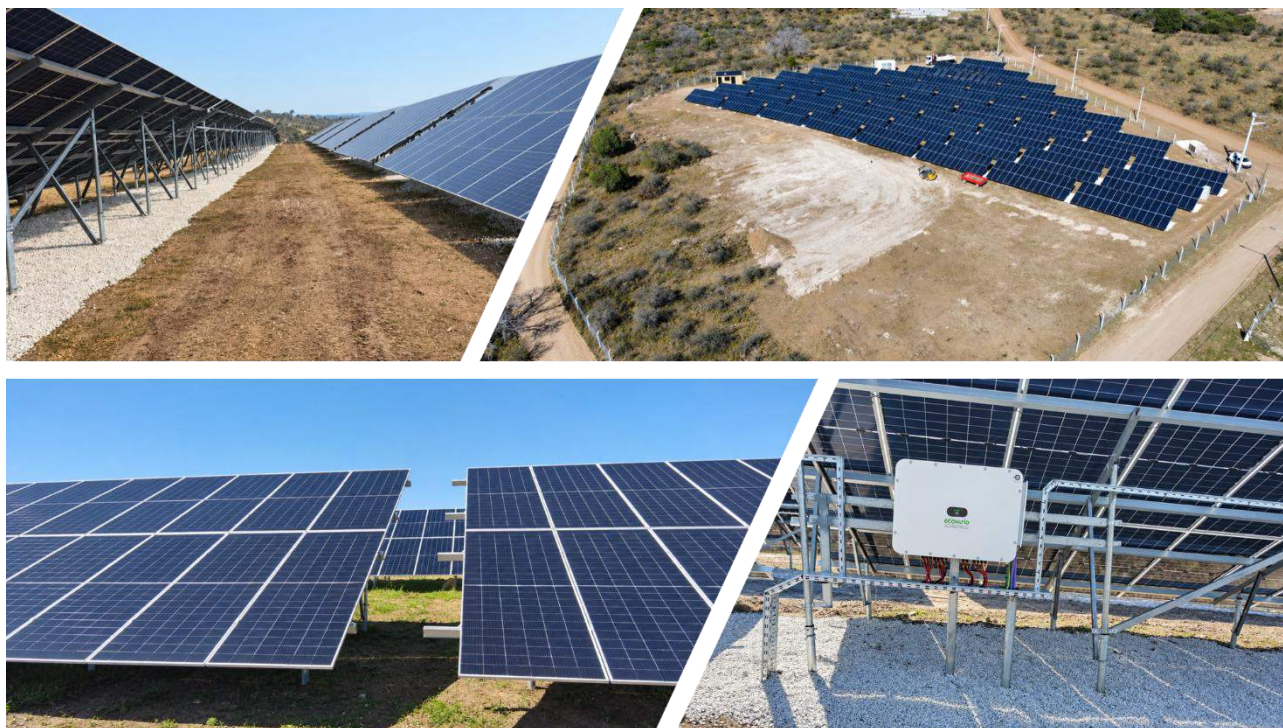
PSFVC Villa General Belgrano – Etapa 1 y 2 finalizada 660 kW potencia de acople
