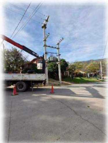
Nueva SET 13,2/0.38kV - 160 kVA en calle Corrientes y Venezuela en VGB (Obra 10.2)
