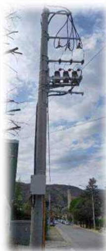
Bloque de Medicion Aéreo 13,2kV Supermercado Cordiez (Obra 11.3)
