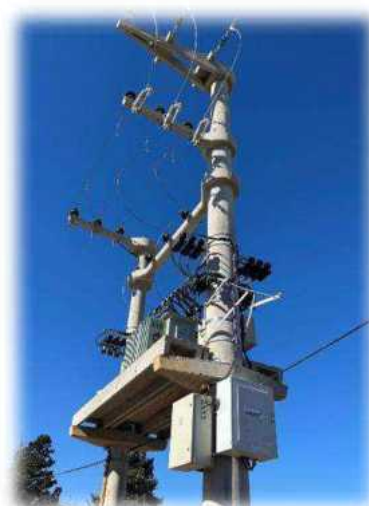
Nueva SET 13,2/0.38kV - 315 kVA en calle Salta y Chile de VGB (Obra 11.4)
