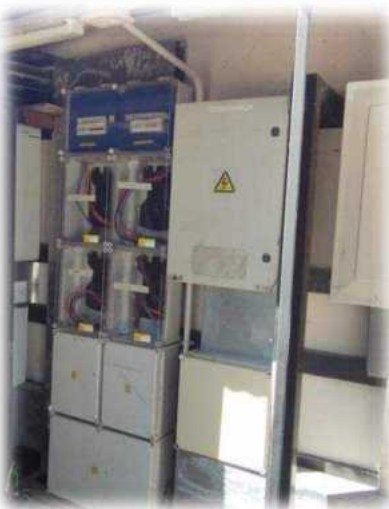
Puntos de Suministros de BT Hotel GET Molvento (Obra 11.1)
