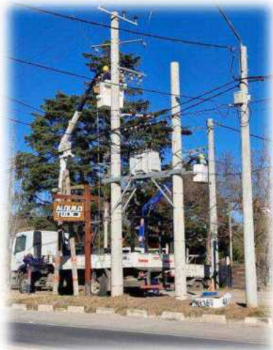
Nueva SET 13,2/0.38kV - 160 kVA de Ruta S-271 (Av. San Martín) y calle Trafal en VGB (Obra 10.3)
