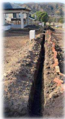
Nueva LSMT vinculación entre nuevas SET's de calle L. Mansilla y red existente BT (Obra 10.4)
