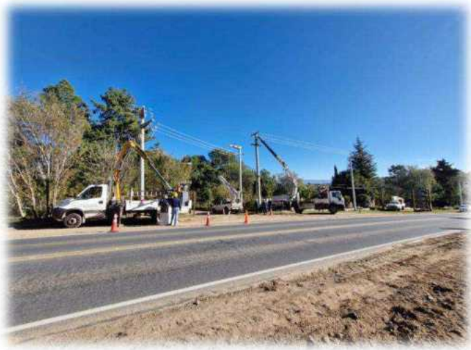
Alimentador N° 1 (Obra 10.5)
