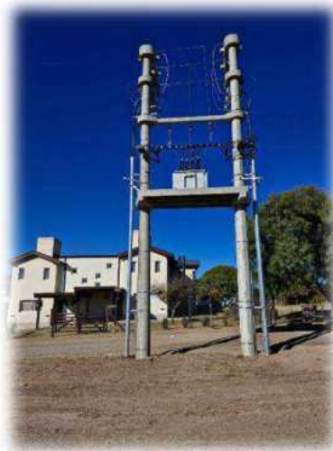
Nueva SET 13,2/0.38kV - 160 KVA en calle L. Mansilla esq. E. del Campo en VGB (Obra 10.4)
