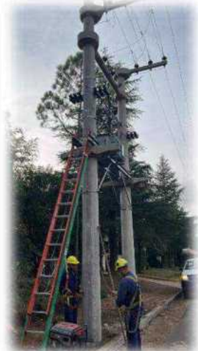
Nueva SET 13,2/0.38kV - 250 kVA Hospital VGB sobre calle Corrientes (Obra 10.2)
