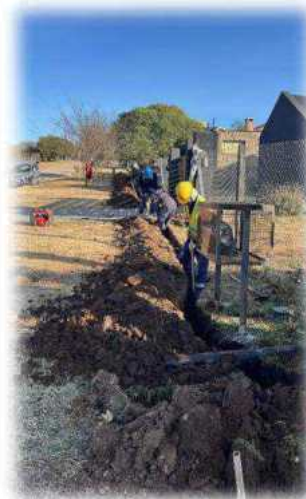
Nueva LSMT vinculación entre nuevas SET's de calle L. Mansilla y red existente BT (Obra 10.4)
