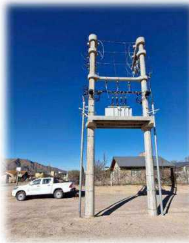
Nueva SET 13,2/0.38kV - 160 kVA en calle L. Mansilla y R. Guiraldes de VGB (Obra 10.4)
